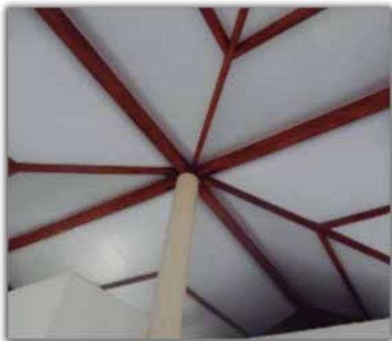
Teto com forro PVC: por meio TAC, parceria Ministério Público (MONTEIRO, 2015).
