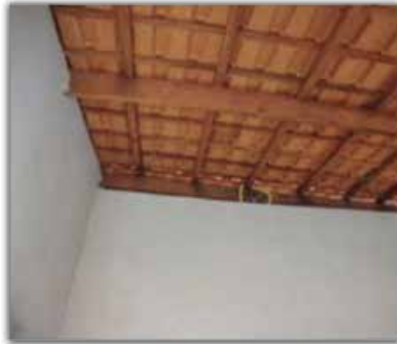
Teto sem forro: desconforto térmico, sujeira, fuligem de cana de açúcar (MONTEIRO, 2014).
