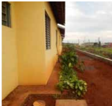
Construção do muro de arrimo e aterramento do terreno: construção por meio de TAC, parceria Ministério Público (MONTEIRO 2015).
